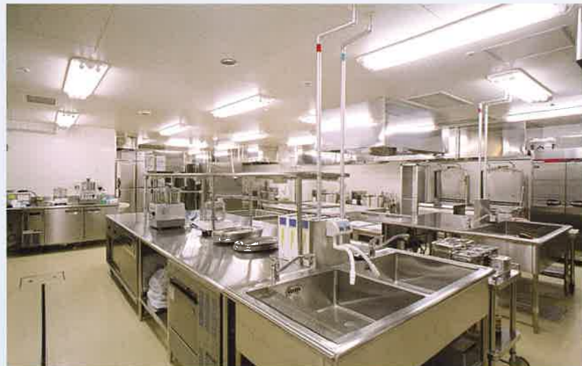
❁オール電化の病院厨房
